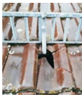
Kaputte Ziegel und Unterspannbahn sowie verfaulte Dachlatten auf dem Rathausdach
